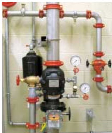
Poste de contrôle
